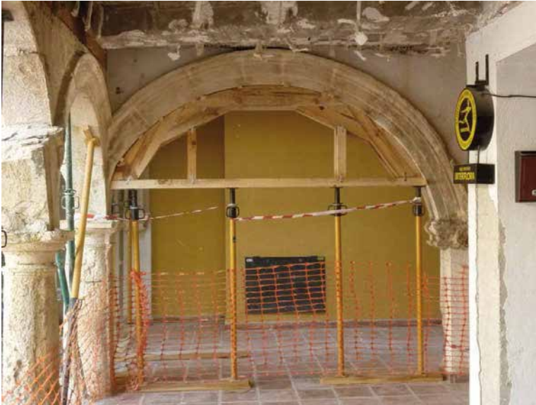
Figura 8.42. Cimbra a base de armazón de madera no adecuadamente triangulada, careciendo de los elementos indicados en la figura anterior (pares, pendolón, contra-par y puente doble) donde se representan los detalles de cimbra para arcos y bóvedas. (Curso superior de restauración y conservación de la edificación, tema 4 medios auxiliares de Pedro E. Collado.).
