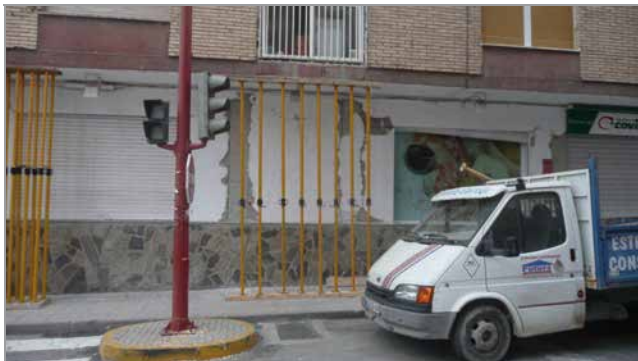
Figura 8.16. Edificio en voladizo. Apeo de urgencia.
