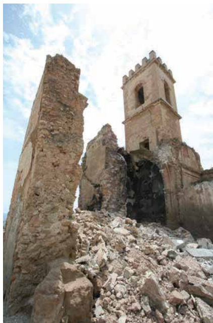
Figura 9.60. Iglesia de San Pedro. Desplome del muro de cerramiento en Sector 1.
