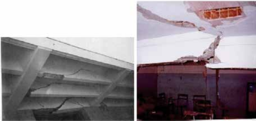
Figura 3.33. Fisuración en vigas tras un sismo (Fuente: Astorga, 2009)
