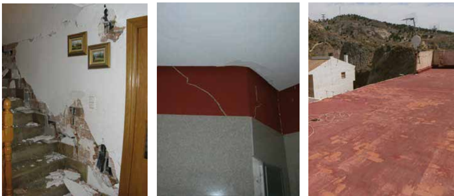
Figura 7.6. Ejemplos de daños en elementos comunes no estructurales interiores y de cubierta.
