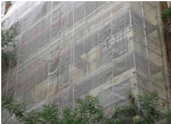
Figura10.35 Redes de protección fachada.
