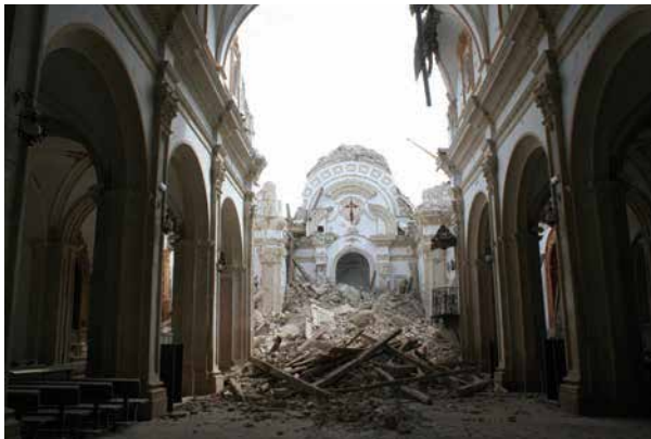
Figura 9.58. Iglesia de Santiago. Colapso de arcos, bóvedas y cúpula del crucero.
