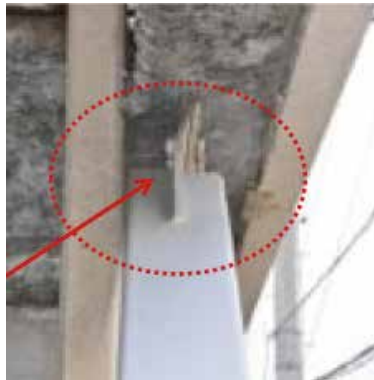
Figura 2.15. Deformación en cartela de unión diagonal-pórtico (Fuente: Ávila, 2011)
