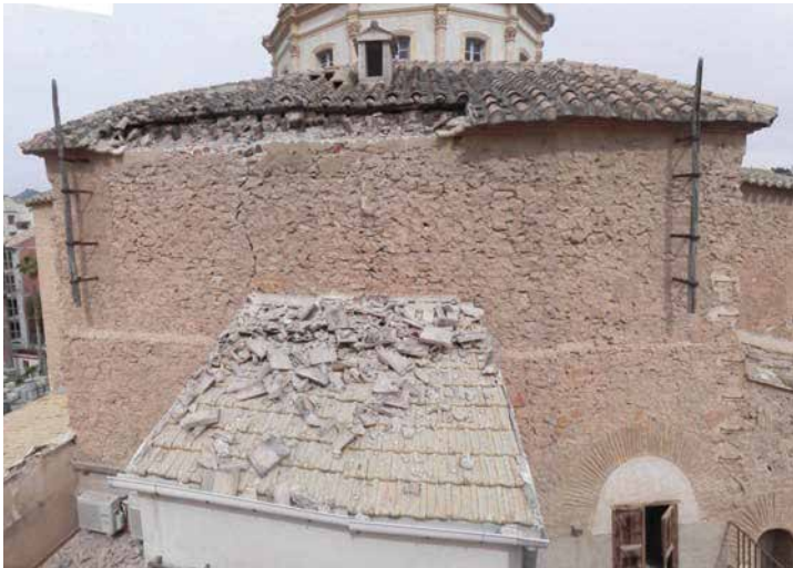
Figura 4.102 47 : Imagen desprendimiento de alero en Lorca.
