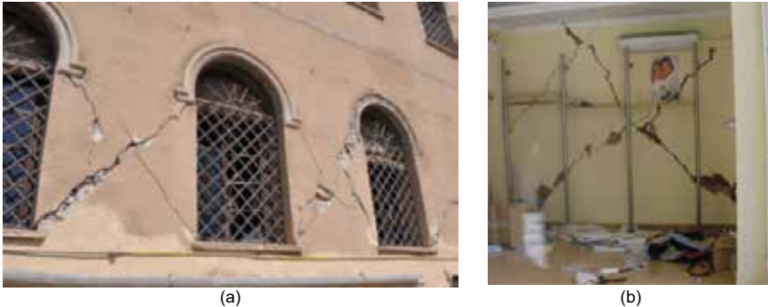
Figura 3.45. Agrietamiento en cruz. (a) En muro (Foto: Bomberos de Cartagena, 2011). (b) En tabiquería (Foto: Dpto. Ing. Civil UPCT, 2011)
