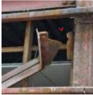
Figura 2.13. Fractura de placa (Fuente: Ávila, 2011)
