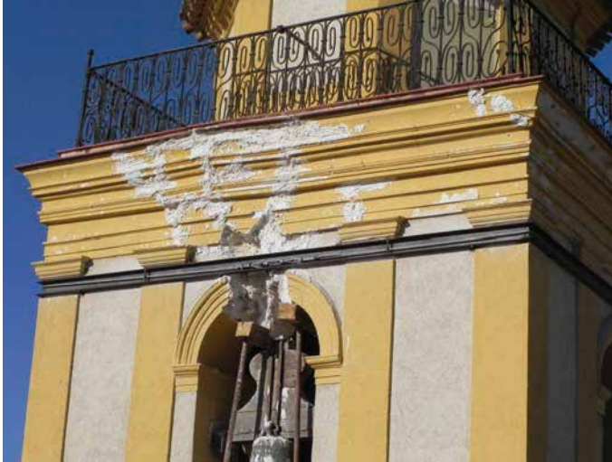
Figura 9.9. Detalle del perfil metálico coyuntural colocado en la torre de la Iglesia de San Cristóbal, alojando en su interior un cable de acero y un tensor, de forma que pueda calibrarse la abertura y tensión del mismo y evitar, por supuesto, que continúe la separación de las fábricas.
