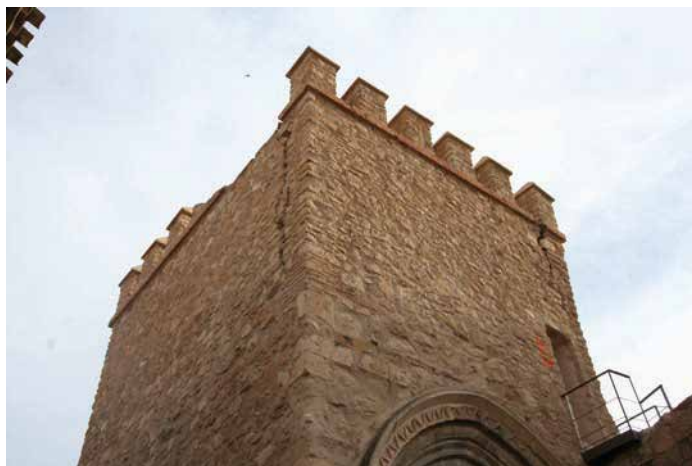
Figura 4.129: Porche de San Antonio. Fractura de las esquinas NO y NE y desplome hacia el interior de almenas.
