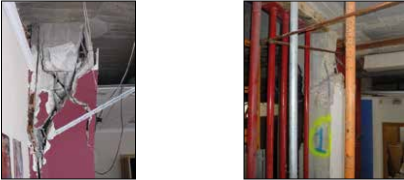
Figura 5.1. Algunos pilares con roturas y desplazamiento.
