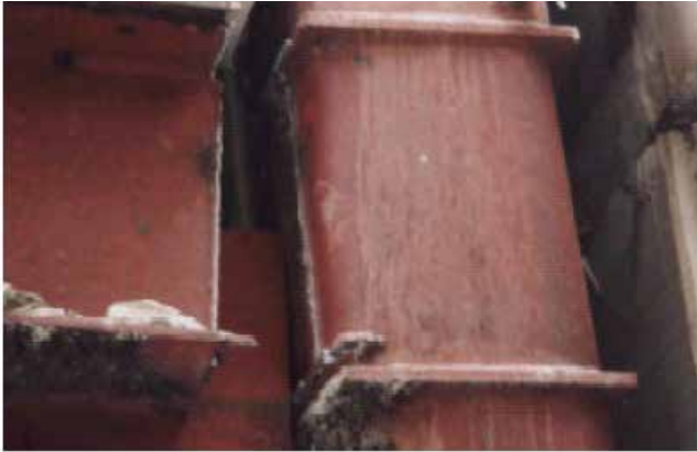
Figura 2.17. Daño unión soldada
