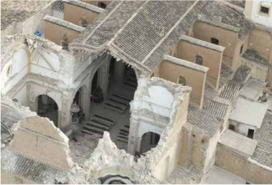
Figura 4.61: Se observan las grietas inclinadas en los contrafuertes. Lorca.
