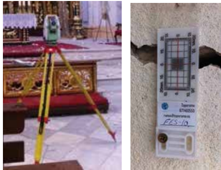
Figura 9.4. Una de las tablas de resultados con las mediciones instrumentadas realizadas en la Iglesia de Nuestra Señora del Carmen (en rojo, los puntos con incrementos severos). Debajo: Teodolito utilizado, así como una de las regletas utilizadas durante las mediciones.
