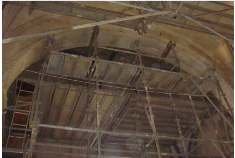
Figura 8.55a. Apeo supletorio para formación de andamio estructural, mediante puntales telescópicos o tubos de acero a los que se sueldan cada 50 cm. rosetas del tipo Peri Up Rosett.
