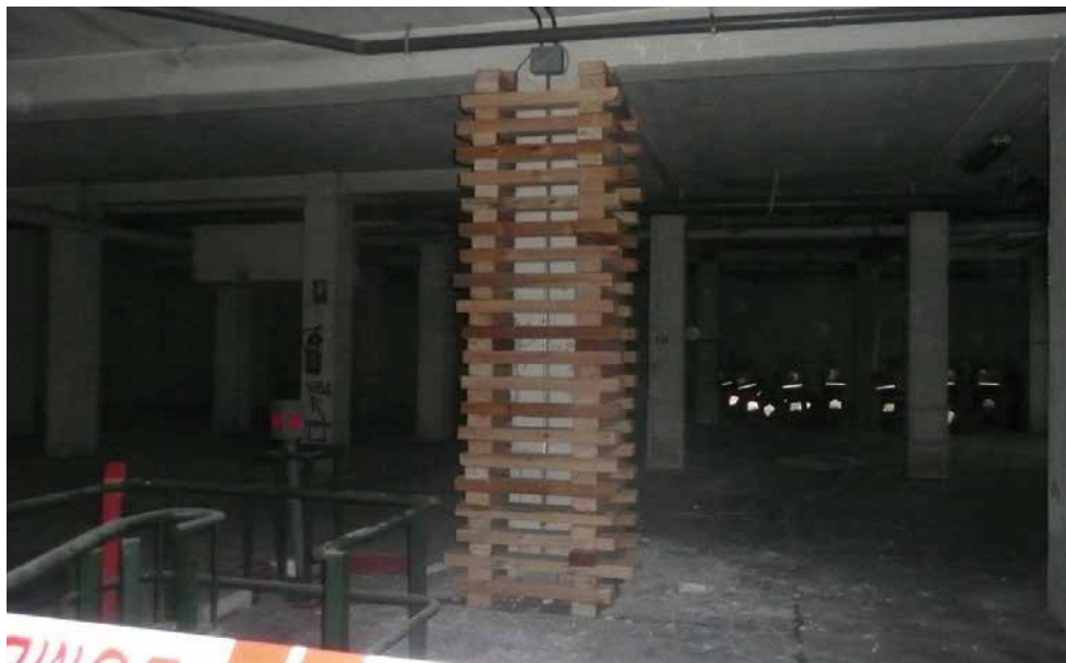
Figura 8.10. Diseño de apeo complementario de pilar y su protección. Edificio Residencial San Mateo, de Lorca.
