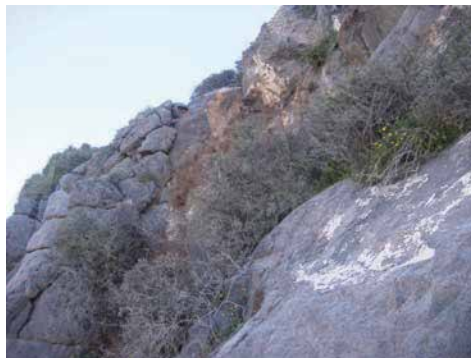
Figura 1.12. Afloramiento rocoso, fuente de desprendimientos.
