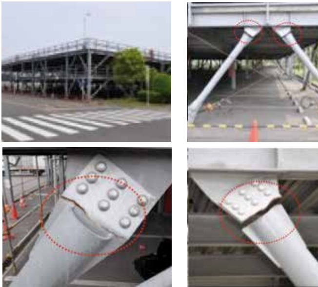
Figura 2.16. Fracturas en las cartelas de unión (Fuente: Ávila, 2011)
