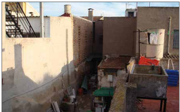
Figura 10.5. Elementos a descontaminar: Depósitos y bajantes de fibrocemento (amianto)
