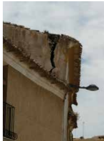
Figura 4.44: Empuje de estructura de cubierta, creando vuelco y grieta lateral más abierta en la zona superior.
