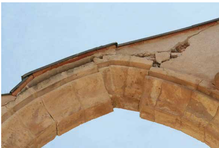
Figura 4.150. Iglesia de Santa María. Desplazamiento de la dovela de la clave del arco de la nave lateral.
