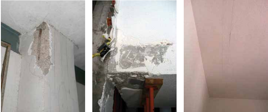
Figura 7.5. Ejemplos de daños en elementos estructurales interiores: 1. Daños en cabeza del pilar con desprendimiento del recubrimiento y deformación de sus armaduras. 2. Daño por cortante en viga. 3. Daños en viguetas por exceso de deformación del forjado.
