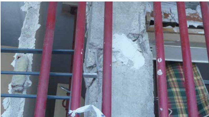
Figura.8.14. Lesión grave en cabeza de pilar de planta baja por cortante.
