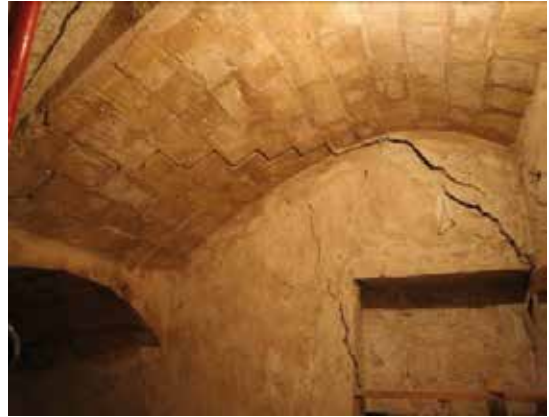
Figura 4.72 37 : Imagen escalera fracturada Lorca.
