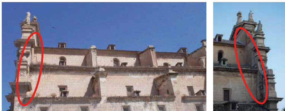
Figura 9.1. Grietas en la Ex Colegiata de San Patricio, en la unión de los muros laterales de las naves, con el imafron de la fachada principal. El análisis de las mismas, así como la documentación existente, demuestra que no fueron causadas por el terremoto de Mayo de 2.011, sino por uno/s anterior/es
