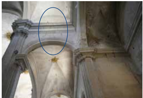
Figura 4.54: Imagen arcos con grietas inclinadas en La Colegiata, Lorca.
