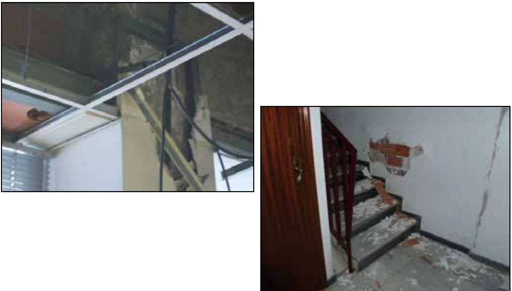
Figura 5.5. Desperfectos en falsos techos y en revestimientos.
