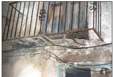
Figura 10.4. Elementos a recuperar.
