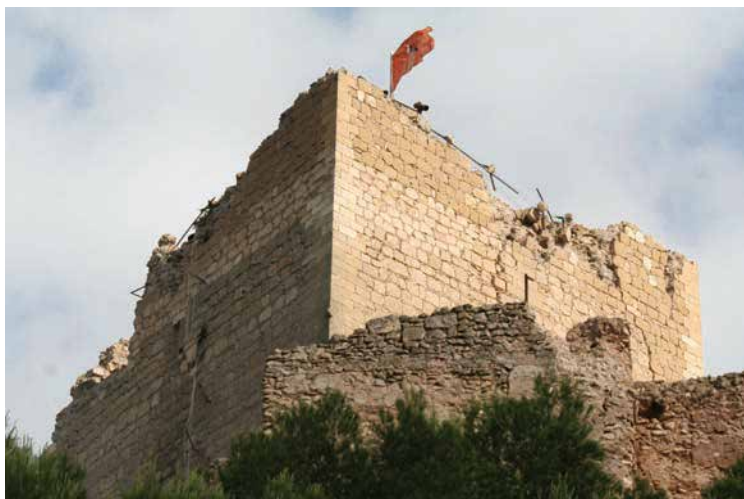
Figura 4.124: Desplome de almenas y rotura de cubierta en la Torre del Espolón.
