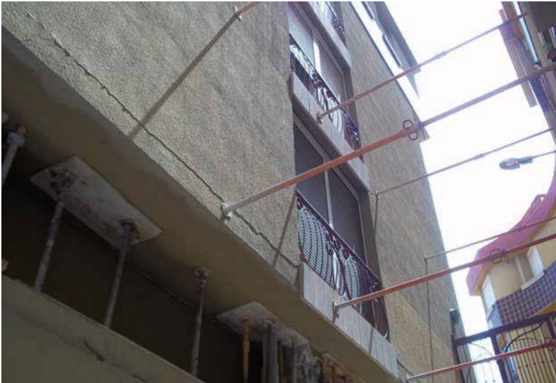
Figura 8.58 Fachada apeada en Lorca. Terremoto Mayo 2011.
