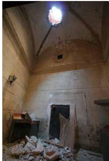
Figura 4.154. Rotura cubierta y bóvedas capilla.
