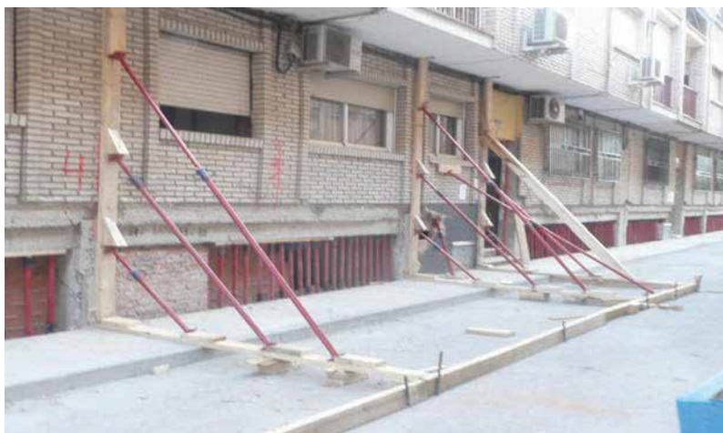
Figura 8.33. Apeo complementario de desplome de cerramiento planta baja coincidiendo con los pilares con la posibilidad de afectación de los mismos.
