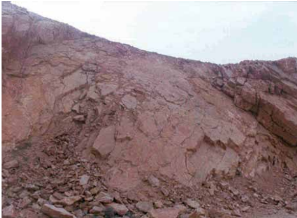
Figura 1.27. Pérdida de un talud excavado por rotura plana.
