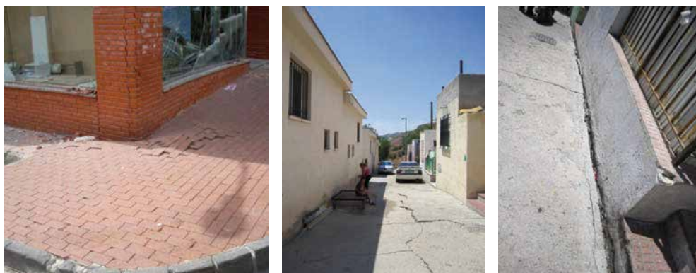
Figura 7.4. Ejemplos de fallos por hundimiento de la cimentación y/o anomalías del terreno.
