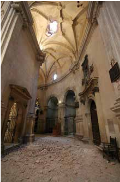
Figura 4.153. Rotura cubiertas y bóveda girola.
