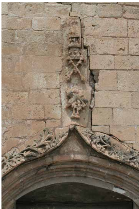
Figura 4.132. Vuelco de la hoja exterior del muro en sillería.
