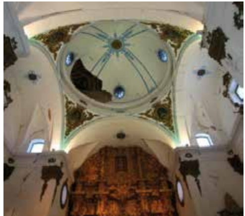
Figura 4.60 Se observan las grietas inclinadas en los cerramientos del crucero. Iglesia de San Francisco. Lorca.
