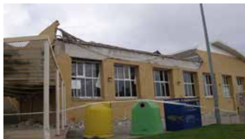
Figura 4.23 27 . Desprendimientos por golpeo entre estructura y revestimientos tras el sismo en Lorca.
