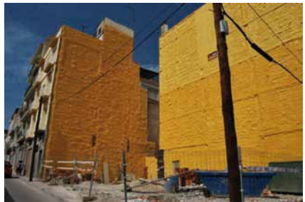
Figura 10.36 Estado de medianeras después de la demolición.
