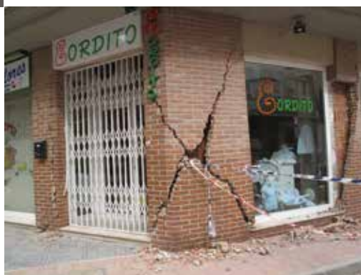
Figura 5.3. Daños en fachadas de planta baja.
