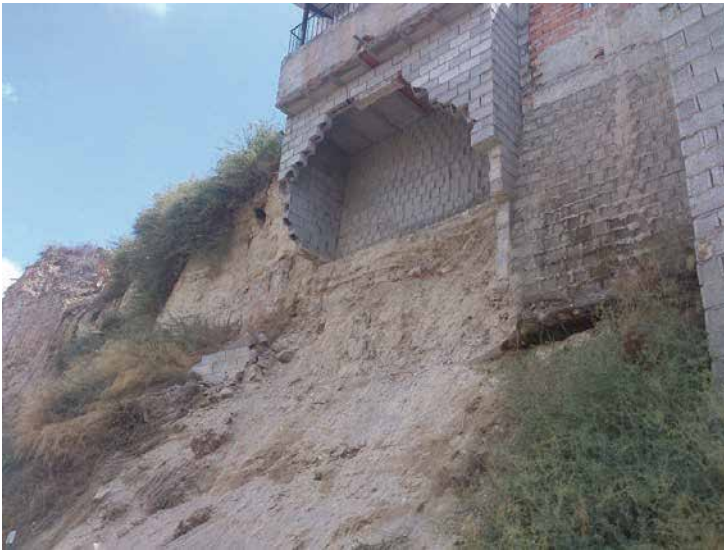
Figura 1.32. Pérdida de cimientos por rotura circular en talud.
