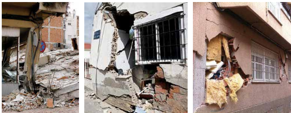
Figura 7.3. Daños por colapso de edificación vecina. 2. Daños en elementos estructurales y no estructurales de fachada. 3. Daños en elementos no estructurales en fachada.
