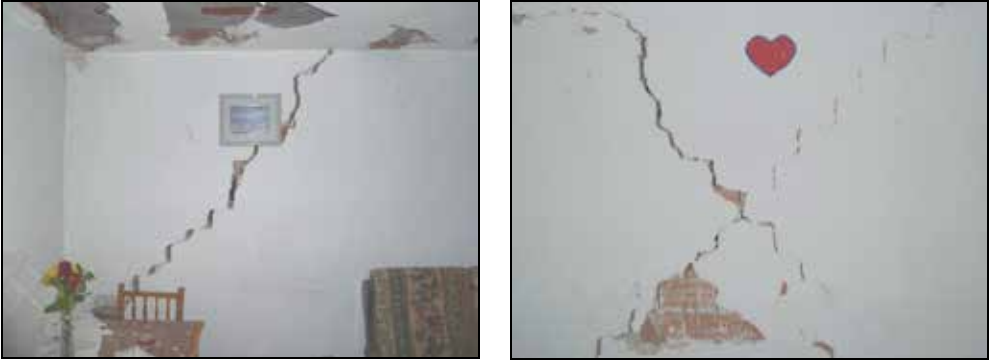
Figura 5.4. Daños en tabiquerías de viviendas.
