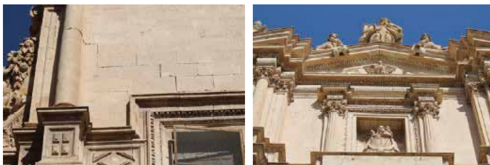
Figuras 4.142 y 4.143. Colegiata de San Patricio. Grietas en muros de sillería de la fachada principal.
