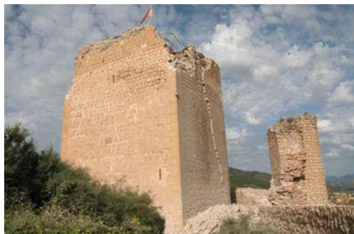
Figura 4.122: Fractura de la esquina NO. Torre del Espolón.
