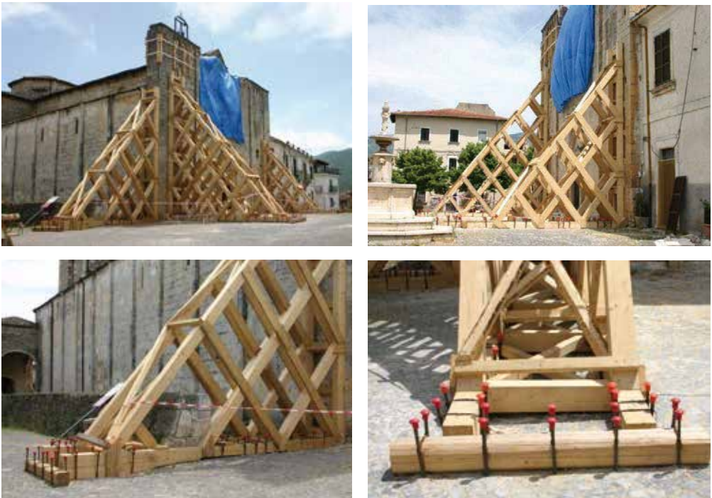
Figura 9.18. Apeos de estabilización de fachadas colocados en la Iglesia de San Eustaquio Forconese (Eusanio) en la localidad de L'Aquila, tras el terremoto de los Abruzos Italianos en Abril del año 2.009
