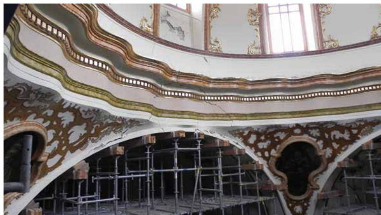
Figura 9.33. Apeo de los arcos del crucero de la Iglesia de Nuestra Señora del Carmen
