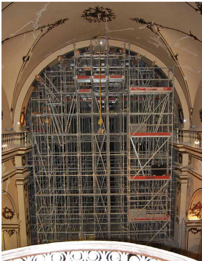
Figura 8.46. Daños en cúpula de la Capilla de Nuestra Señora del Rosario. Lorca. Encimbrado con madera, tubos, bridas y estructura modular de rosetas.
