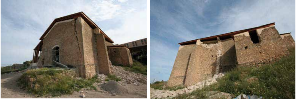
Figuras 4.127 y 4.128: Ermita de San Clemente. Desplome de muro NO, fractura de esquina N y desplome de contrafuerte.
