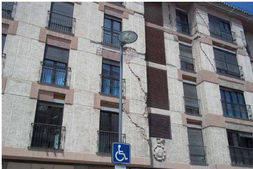
Figura 8.57 Fachada con graves lesiones en Lorca. Terremoto Mayo 2011.
